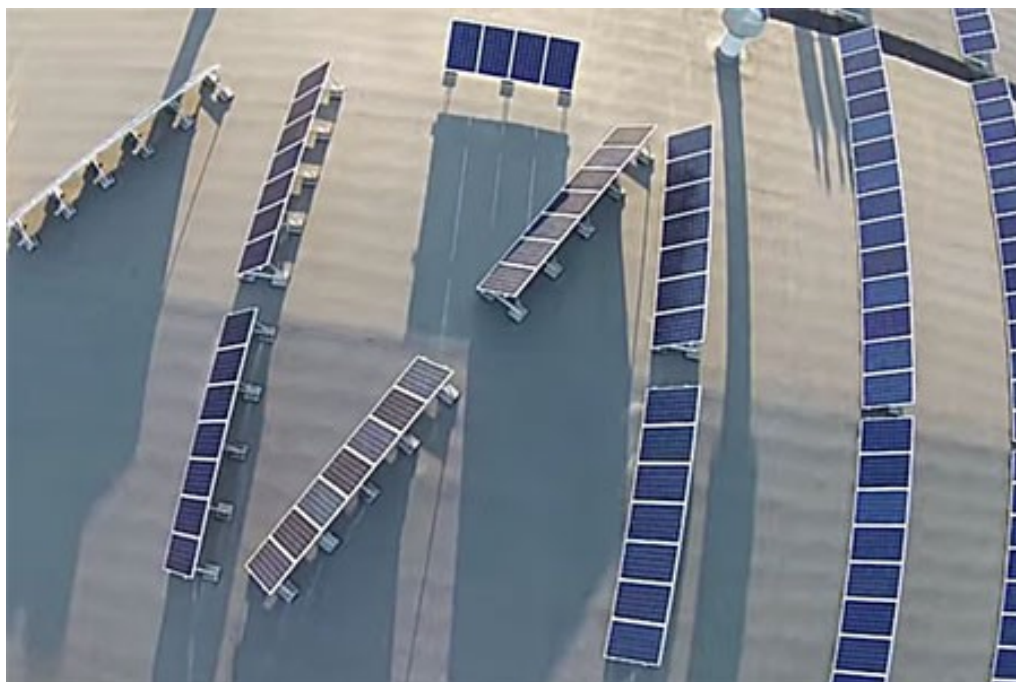
Рисунок 66. – Солнечные модули на крыше завода GOOD-WOOD
