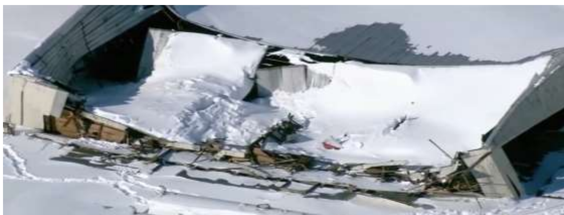
Рисунок 1 - Обрушения кровли вследствие повышенной снеговой нагрузки
