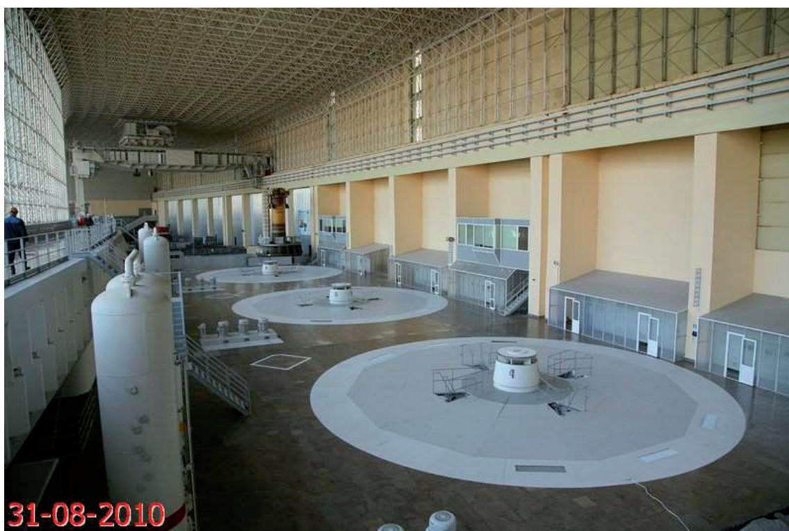
Рис. 4.14. Машинный зал СШ ГЭС 31 августа 2010 г.; частично восстановленный после аварии
