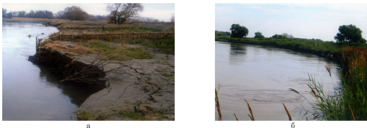
Рис. 2. Состояние береговых откосов р. Терек в границах участка натуральных испытаний биопозитивных конструкций берегозащиты, разработанных применительно к району равнинной зоны Республики Дагестан (фото авторов):
