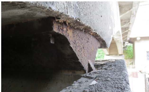
Рис. 8. Поверхностная коррозия опорных элементов (фото Б.А. Бондарева)
