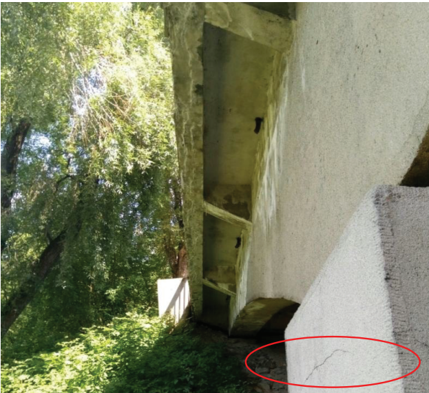
Рис. 5. Горизонтальная трещина опоры в результате морозного разрушения левой консоли 1-й балки у правого устоя (фото Б.А. Бондарева)
