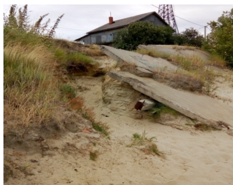
Берегоукрепление сборными железобетонными плитами в аварийном состоянии (поселок Болчары) Shore protection with reinforced concrete slabs in the emergency condition (Bolchary settlement)
