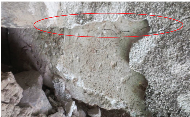
Рис. 6. Горизонтальная трещина до 1 мм в нижнем поясе балки № 2 в растянутой зоне в пролете 2 (фото Б.А. Бондарева)
