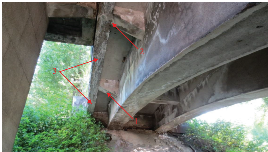
Рис. 7. Повреждения левого устоя:
