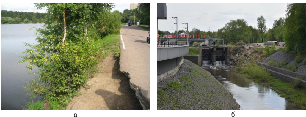
Рис. 1. Повреждения откосов водных объектов:
