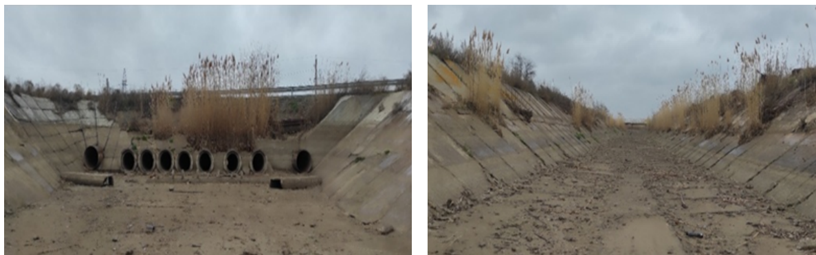
Рис. 2. Фрагмент бетонных конструкций оросительного канала «О-71» Камызякской оросительной сети
