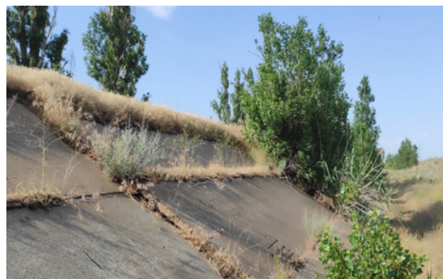
Рис. 1. Фрагмент бетонных конструкций оросительного канала Генераловской оросительной сети Fig. 1. Fragment of concrete structures of the irrigation canal of the Generalov irrigation network
