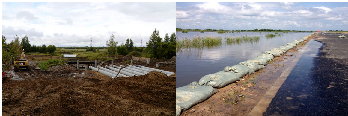
Рис. 11. Реконструкция насосной станции на полейдерной системе Большого Уссурийского острова (слева) и дамба обвалования системы при аварийном повышении уровня воды в р. Амуре (справа)
