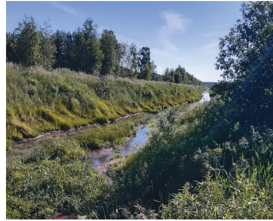
Рис. 2. Зарастание травянистой и древесно-кустарниковой растительностью и заиление осушительного магистрального канала на мелиоративном объекте Тинки-II
