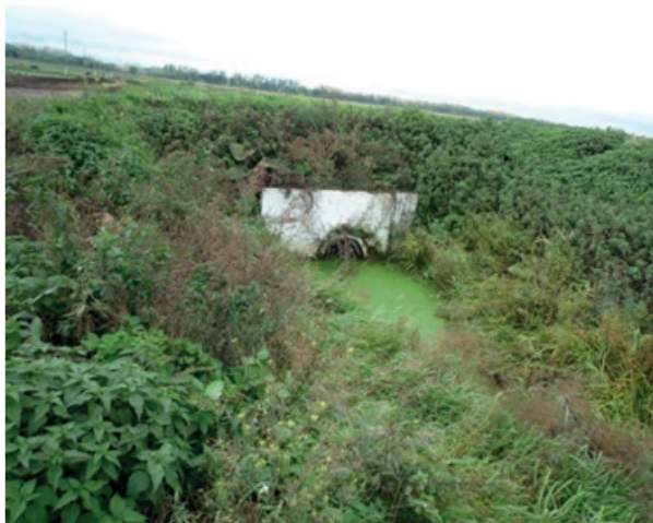
Рис. 2. Состояние сетевых сооружений на торфяном основании на сентябрь 2013 г. (Яхромская пойма)
