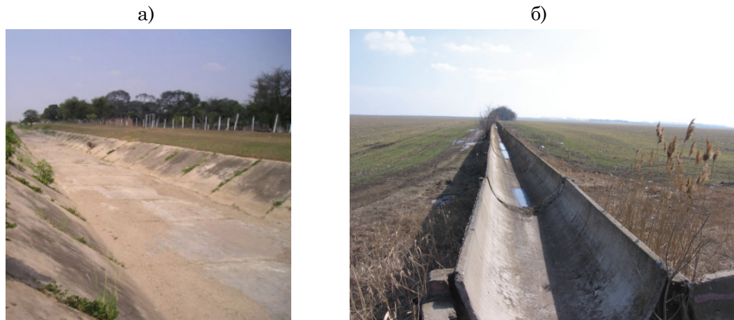
Рис. 1. Состояние бетонных облицовок оросительных каналов после их длительной эксплуатации:
