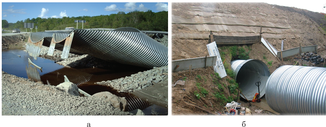
Рис. 1. Примеры состояния и использования труб из МГК на автодорогах: а – разрушение 2-х очковой МГТ на 24 км дороги Хабаровск-Владивосток в первые годы эксплуатации, 2006 г.; б – удлинение железобетонных трубчатых водопропускных сооружений при помощи СГМТ без вскрытия насыпи
