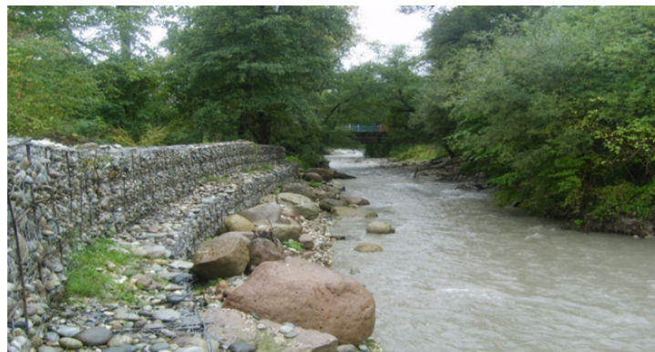
Рис. 5. Участок берегоукрепительного сооружения на р. Шалущка, построенный с возведением подпорных стен из габионов по патенту № 2336389 (фото авторов)
