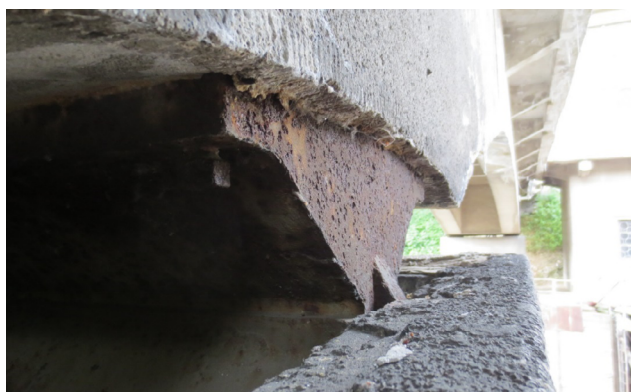
Рис. 8. Поверхностная коррозия опорных элементов (фото Б.А. Бондарева)
