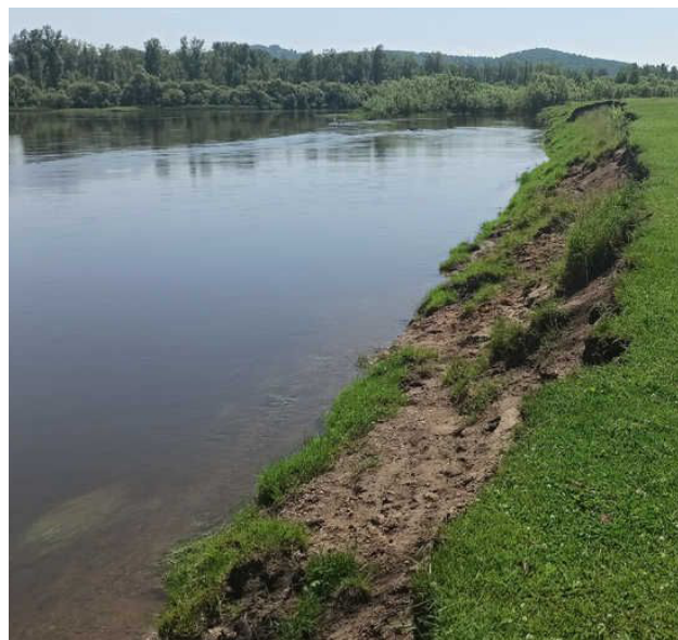
Рис. 1. Обрушение и эрозия неукрепленных береговых склонов реки Жиздра (фото Т.Ю. Жукова)
