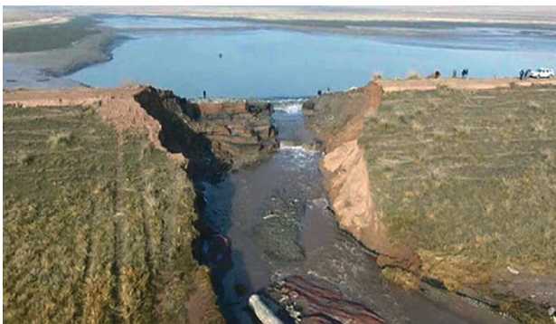
Рис. 2. Прорыв грунтовой плотины Сардобинского водохранилища (фото – сайт cawater-info.net)
