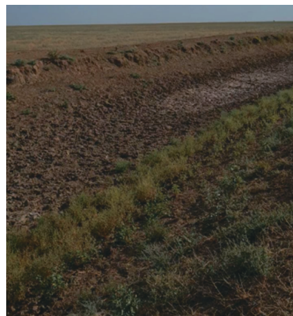
Рис. 3. Современное состояние канала Р1, где прослеживается заиление наносами и обрушение откосов, 2021 г.
