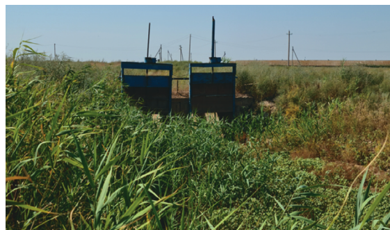
Рис. 4. Перегораживающее канал Р1 двухочковое сооружение (сооружение неисправно), 2021 г.
