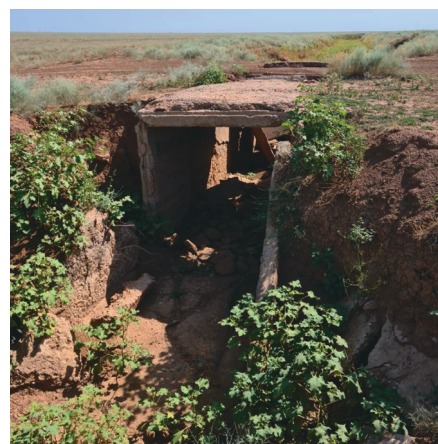
Рис. 6. Трубопереезд на канале (состояние неработоспособности), 2021 г.
