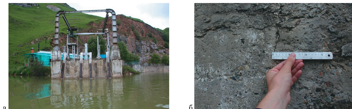
Рис. 3. Обследование водозаборного сооружения: а – общий вид; б – образование продольных трещин
