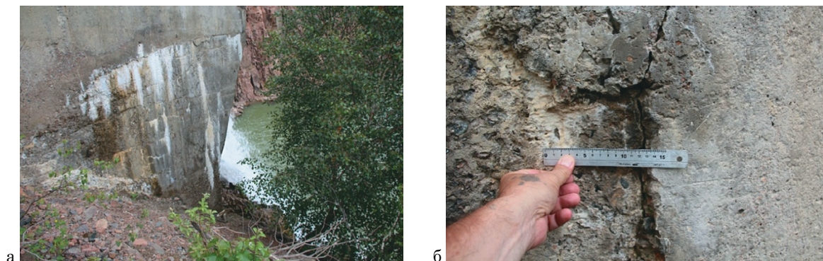
Рис. 2. Дефекты паводкового консольного водосброса: а – коррозия бетона; б – образование поперечных трещин с дальнейшей фильтрацией воды
