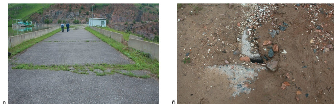
Рис. 6. Дефекты каменно-земляной плотины: а – произрастание растительности; б – разрушение стыков облицовки
