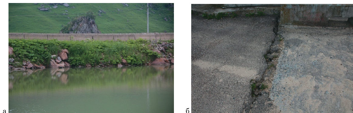
Рис. 5. Обследование каменно-земляной плотины: а – общий вид; б – разрушение железобетона на стыках моста
