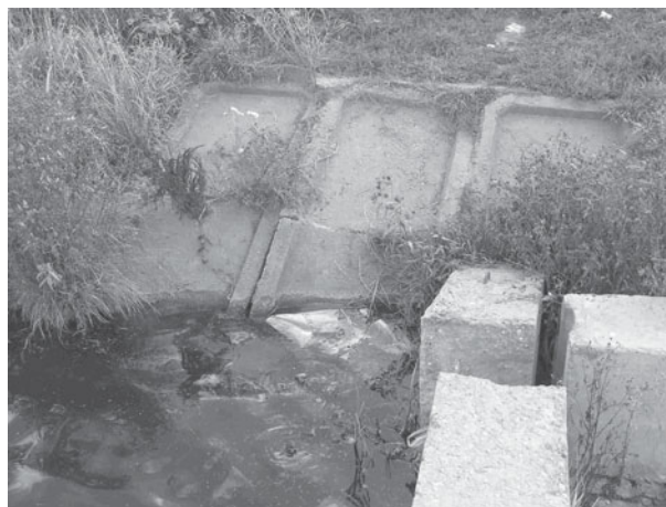
Рис. 4. Состояние крепления верхнего откоса плотины и входного оголовка водосброса пруда № 3 в усадьбе (2008)
