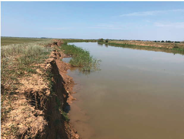
Рис. 2. Деформация откосов ПМК на ПК 1630-1640
