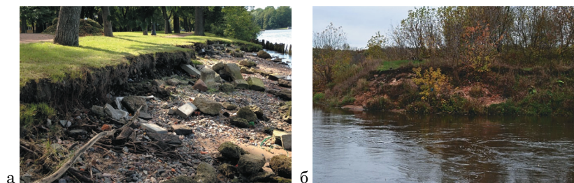
Рис. 2. Эрозия берегов водотоков:
