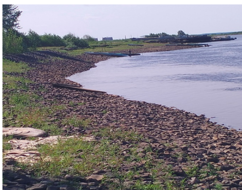
Берегоукрепление из каменной наброски (поселок Кондинское) Shore protection made of stone fill (Kondinskoye settlement)
