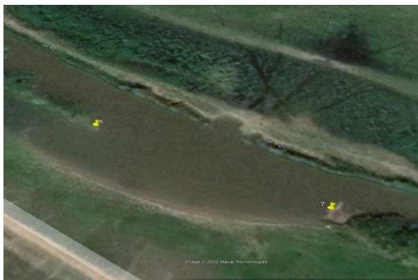
Рис. 3. Разрушение гребня канала
