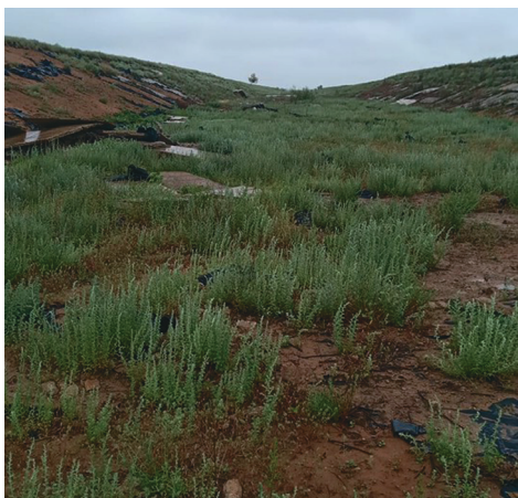
Рис. 4. Канал протяженностью 13,2 км, ведущий от второй насосной станции системы КАРОС (НС-2) до законсервированной в настоящее время насосной станции, непосредственно обслуживающей орошаемые участки.
