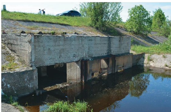
Рис. 3. Водосбросное сооружение с отсутствующими плоскими затворами, подъемниками и сородерживающими решетками
