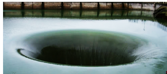
Рис. 2. Фото перелива воды через водоприёмную воронку шахтного водосброса
