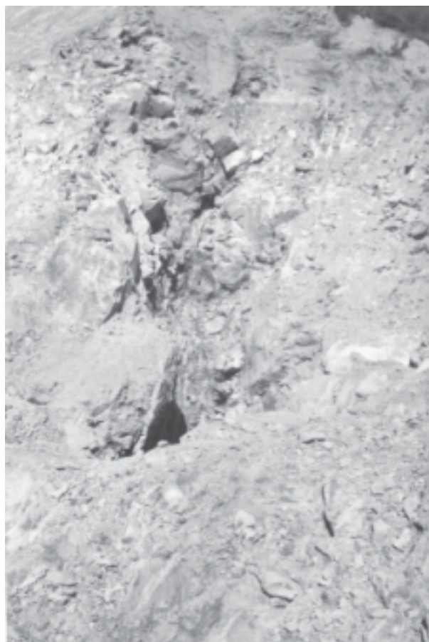
Рис. 9. Обнаружение трещин и пустот при расчистке русла реки Беит Яшут
