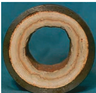
Рис. 1. Сечение стального трубопровода после 8 лет эксплуатации
