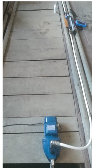
Рис. 2. Экспериментальный трубопровод Fig. 2. Experimental pipeline
