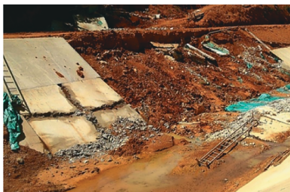
Рис. 3. Пример разрушения канала оросительной системы
