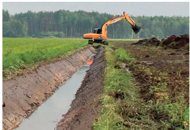
Рис. 2. Осушение земель путем устройства системы открытых осушительных каналов
