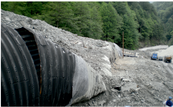
Рис. 2. Русло селевого водотока ПС-6 (левого притока реки Мзымта) с очень высоким уровнем селеопасности. Противоселевая автодорожная галерея раздавлена селевыми массами (апрель 2012 года, Кабардино-Балкария)
