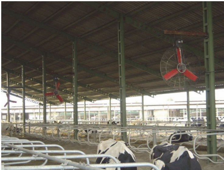
Рис. 14.4. Наклонные вентиляторы над зонами отдыха
