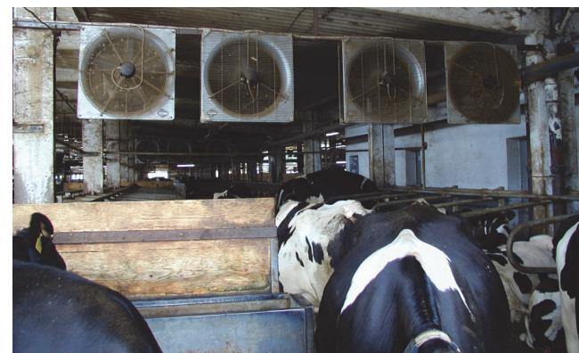
Рис. 14.10. Вентиляторы, расположенные в четыре ряда
