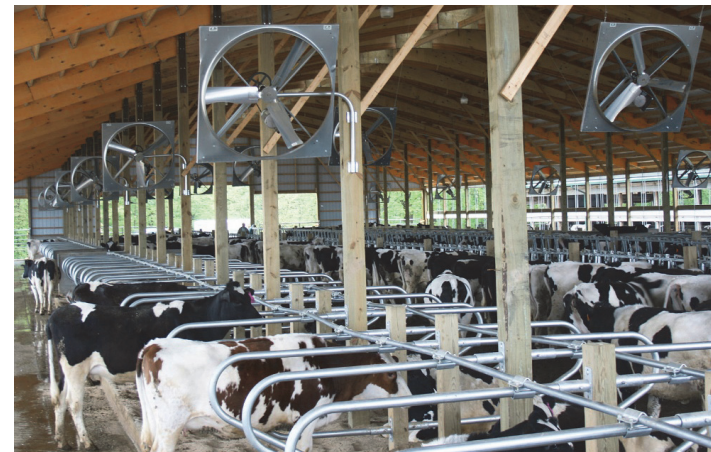
Рис. 14.9. Вентиляторы, расположенные в три ряда
