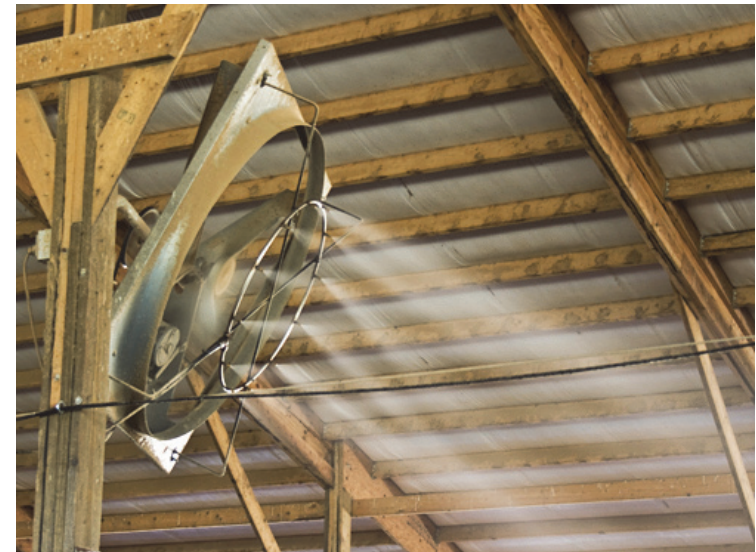
Рис. 14.6. Наклонные вентиляторы с распылением воды
