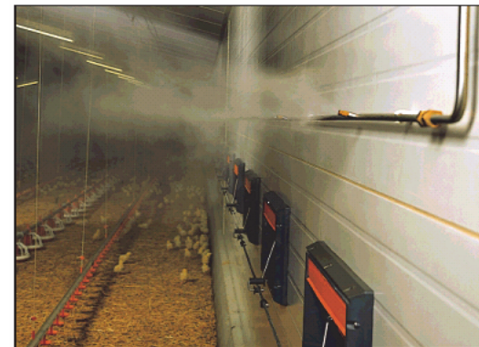
Рис. 10.9. Система увлажнения водой с форсунками высокого давления
