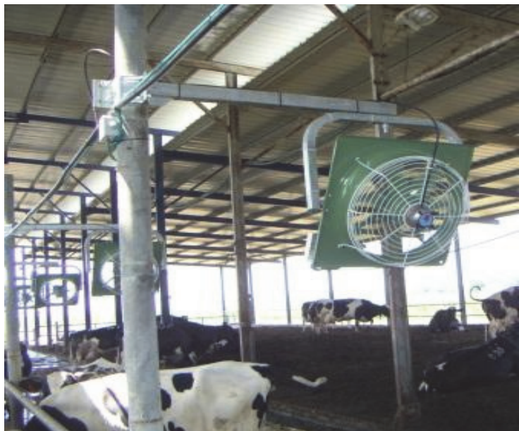
Рис. 14.5. Наклонные вентиляторы над кормонавозным проходом
