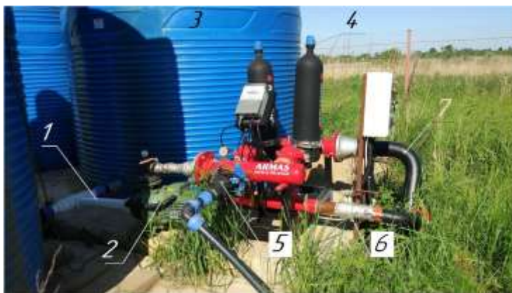
Рис. 1 – Комплект оборудования комбинированной системы (головной узел): 1 – подводящий трубопровод; 2 – насос; 3 – ёмкости с поливной водой; 4 – фильтростанция; 5 – клапан с регулятором давления; 6 – запорный орган; 7 – магистральный трубопровод
