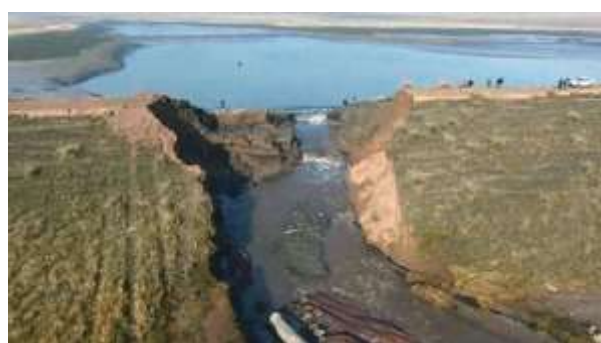
Рис. 2.4. Прорыв земляной плотины Сардобинского водохранилища в Узбекистане, 2020 г.
