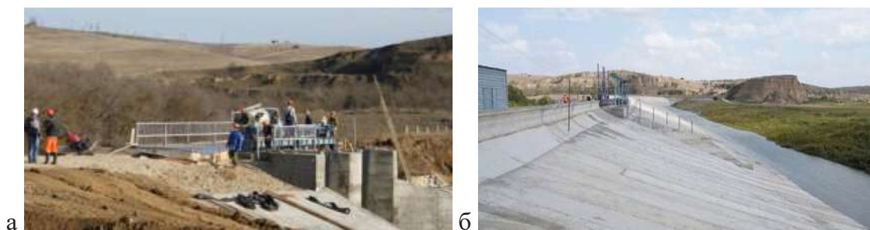
Рис. 3.2. Вид с ВБ на строительство резервного открытого берегового водосброса (а) и волноотбойного парапета на гребне плотины (б)
