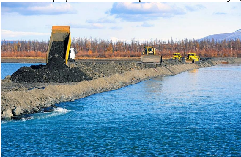
Рисунок 3 – Защита от паводковых вод
