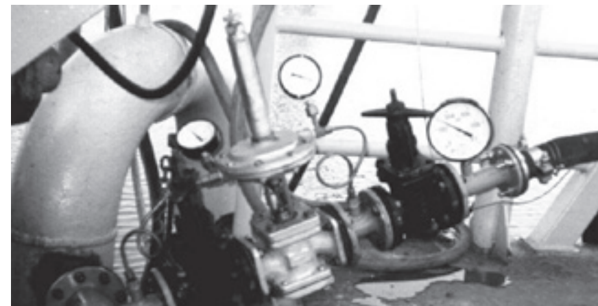
Рисунок 3.7. Узел регулировки давления в трубопроводе подачи воды на потокообразователь РЗУ
