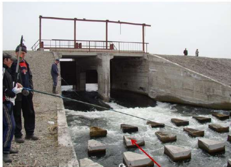
Гасители энергии в конце быстрогока ( Гаситель энергии потока - 消能设备, 消能槛)
