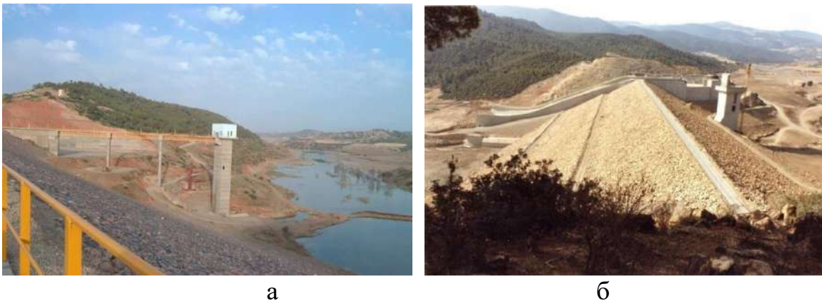
Рис. 4.39. Водовыпуски плотин в Алжире: а – Tiledsit; б - Дер-Дер, Алжир, фото ЗАО «Зарубежводстрой»
