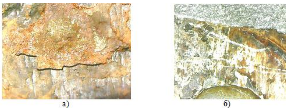
Рис. 4. Фото поверхности образца, восстановленного с использованием ПКМ с алюминиевой пудрой после 120 дней выдержки в воде: а – фото участка металла без покрытия полимерным материалом; б – фото поверхности металла после удаления ремонтного состава
