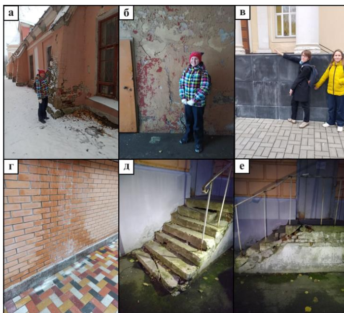
Рис.1. Следы химического выветривания: а – на северной стене корпуса №5 РГАУ МСХА, б – на восточной арке корпуса №5 РГАУ МСХА. Высол. в - высол на мраморных облицовочных плитах на лестнице перед центральным входом в корпус №16 РГАУ МСХА, г – высол на кирпичной кладке, Лиственничная аллея 2д, стена у лестницы к банку. Выветривание. д, е - лестница у северного служебного входа корпуса №6 РГАУ МСХА.
