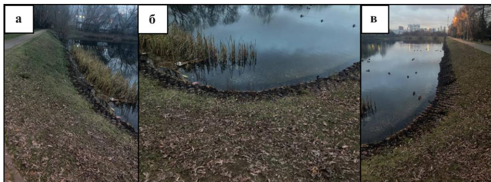
Рис.4. Георешётка, предотвращающая размыв и ползание берега на северо-восточном углу Среднего Фермерского пруда: а – вид на север, б – вид на северо-восток, в – вид на восток.
