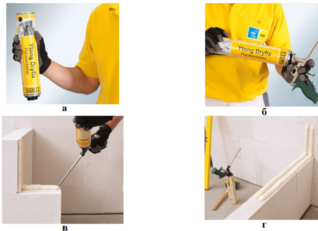
Рис. 3.89. Подготовка к использованию и нанесение клея YTONG Dryfix: а — встряхивание баллона с клеем; б — соединение с ручным дозирующим устройством; в — одинарная дорожка клея для плоских блоков; г — двойная дорожка клея на стенах шириной более 10 см
