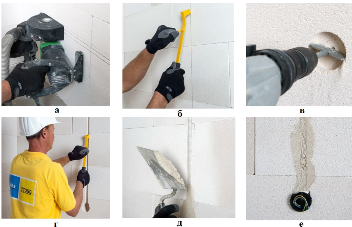
Рис. 3.96. Выполнение пазов для электропроводки: а — горизонтальная канавка, выполненная с помощью стеновой фрезы; б — выполнение канавки ручным штроборезом; в — выполнение отверстия для вставки розетки; г — вертикальная канавка для электромонтажа; д — заполнение раствором; е — заполненная канавка
