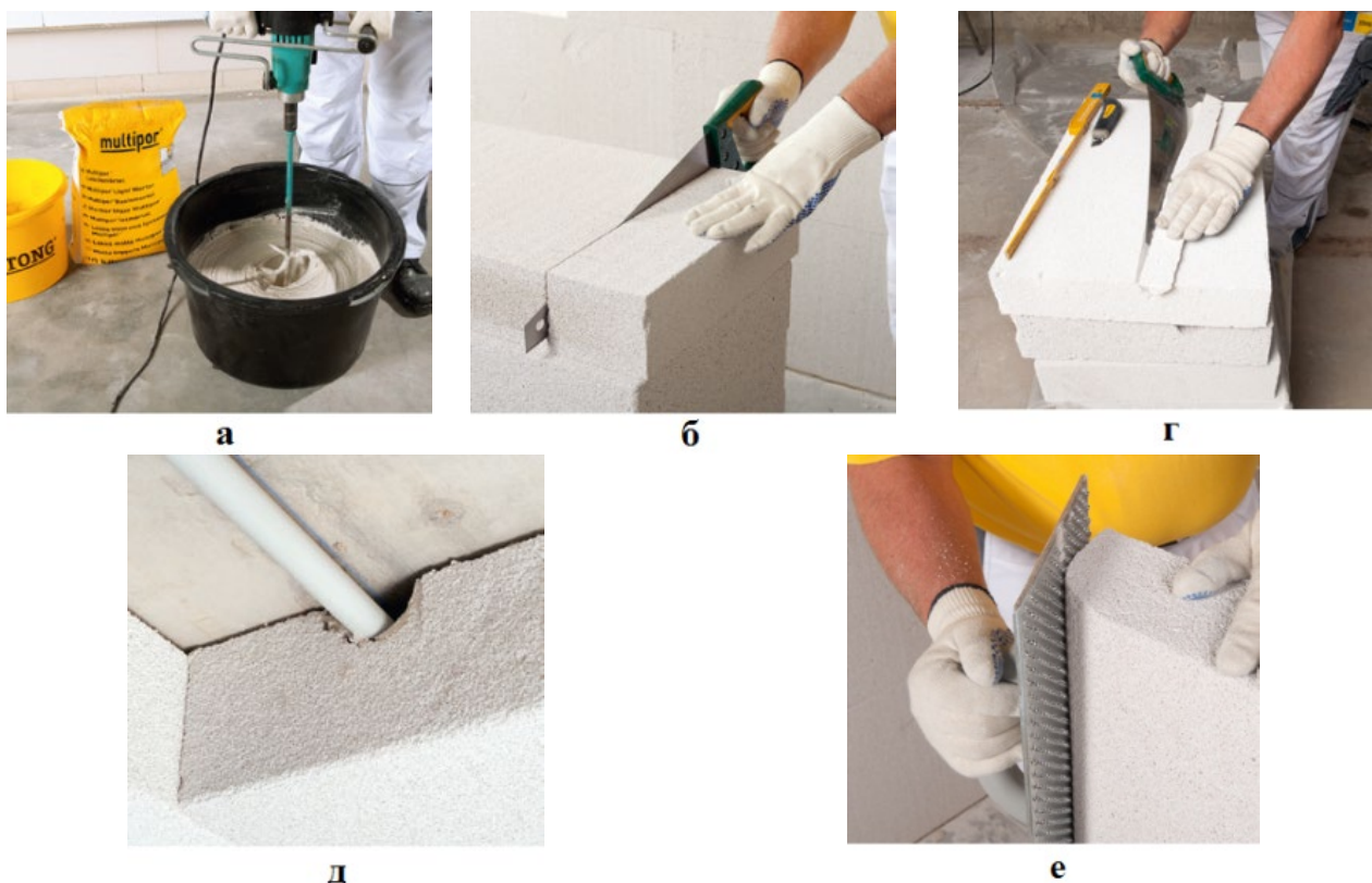
Рис. 4.9. Работы с инструментом Multipor: а — перемешивание легкого раствора; б — обрезка; в, г, д — вырезание паза в плите для существующей трубы; е — подгонка закругленных краев плиты и углов
