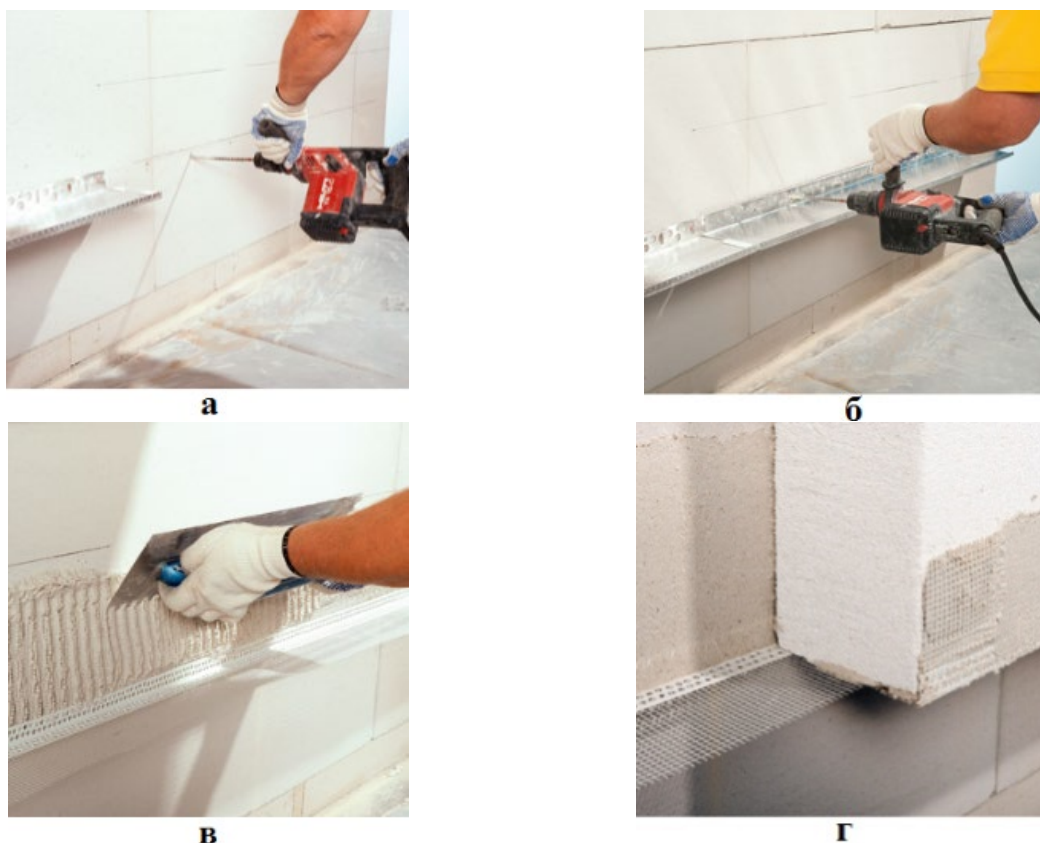
Рис. 4.43. Монтаж цоколя: а, б — монтаж алюминиевого цокольного профиля; в, г — монтаж цоколя с сетчатыми уголками
