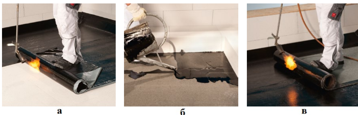
Рис. 4.81. Гидроизоляция кровли: а — первый слой гидроизоляции в качестве термически активируемого самоклеящегося полотна для холодного монтажа; б — укладка изоляционной плиты в горячем битуме; в — второй слой гидроизоляции
