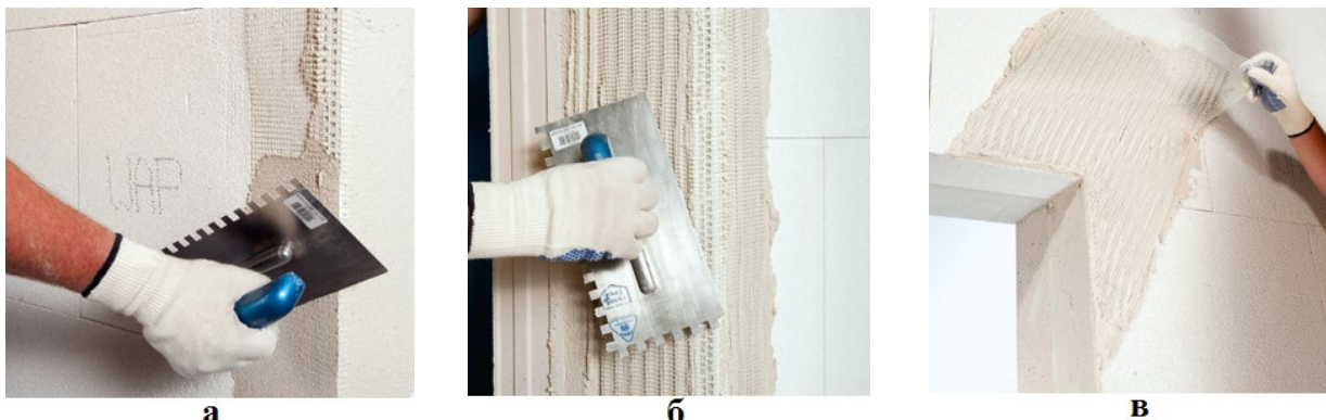
Рис. 4.49. Устройство углов: а — сетчатый угловой профиль в наружном углу; б — угловой профиль с сеткой на отверстии; в — стрелка из армирующей сетки над оконным проемом
