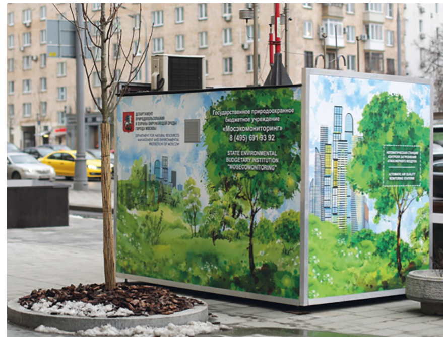
Рис. 1.2. Автоматическая станция контроля загрязнения атмосферы (АСКЗА)
