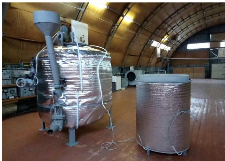
Рис. – Общий вид биогазовой установки
