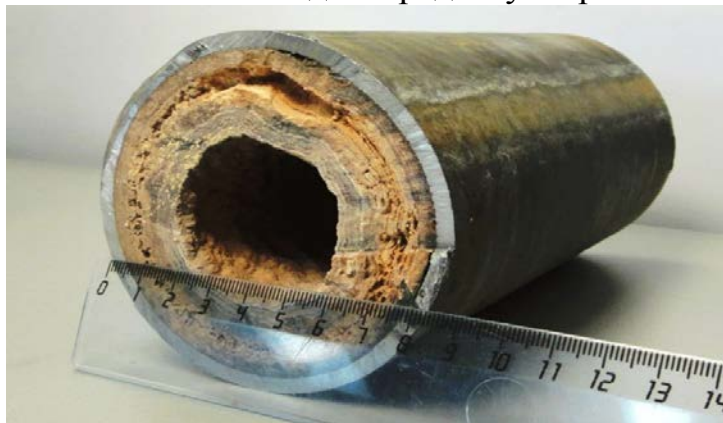
Рис. 1 Бывший в употреблении трубопровод
