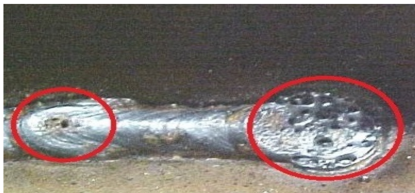
Рис. 4 Поры в сварочных швах
