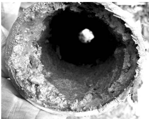
Рис. 1. Накипные отложения на внутренней поверхности трубы теплообменника
