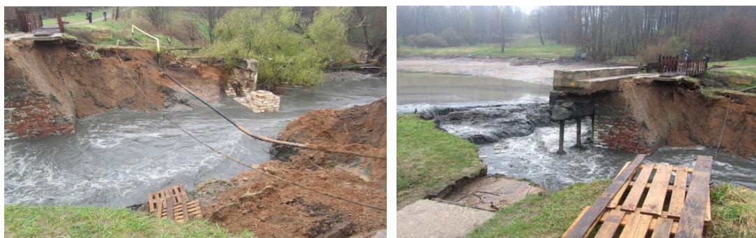
Рисунок 2. Прорыв бесхозяйной плотины Сухановского пруда с грунтовой плотиной в Ленинском районе Московской области, р. Гвоздянка, 2014 г.
