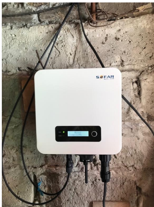
Рисунок 3.3 – Установленный инвертор Sofar
